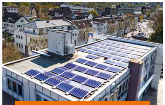
Solaranlage Hauptstelle Duisdorf
